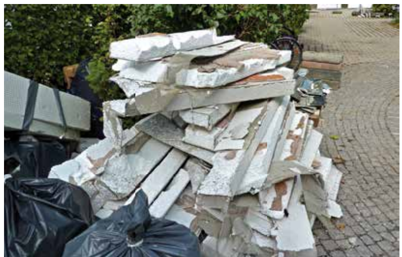
Durch Gewebespachtelungen, Putz und Kleber wird ein Wärmedämmverbundsystem bei Ausbau zum Sondermüll.
