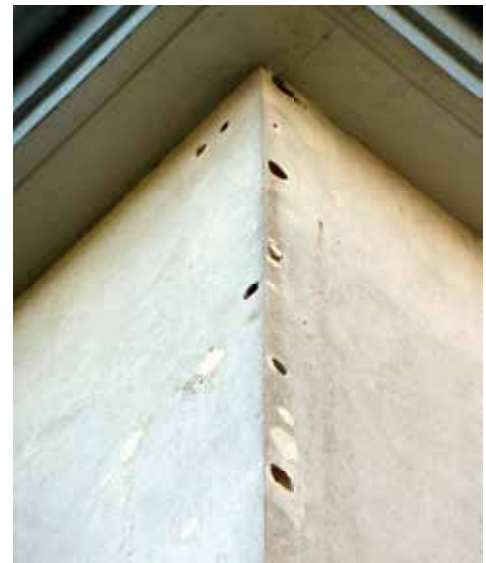
Spechtlöcher im Wärmeverbundsystem
